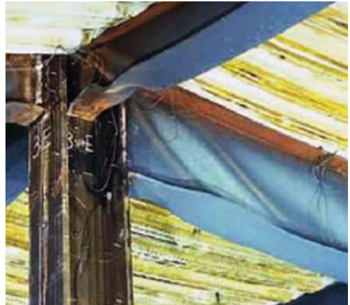
Рис. 3.5.6. Потеря местной устойчивости полки и стенки балки
